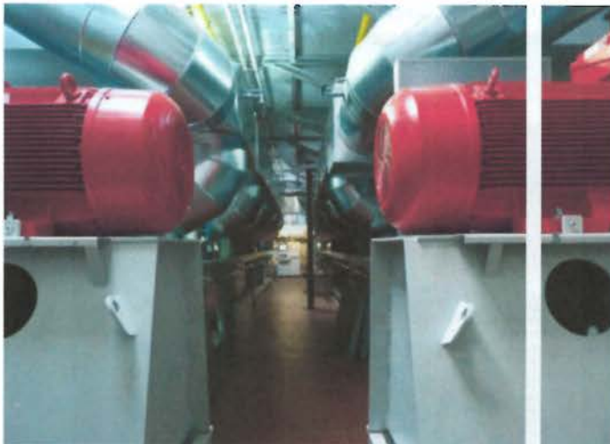
Maschinenraum der RTO-Anlage
