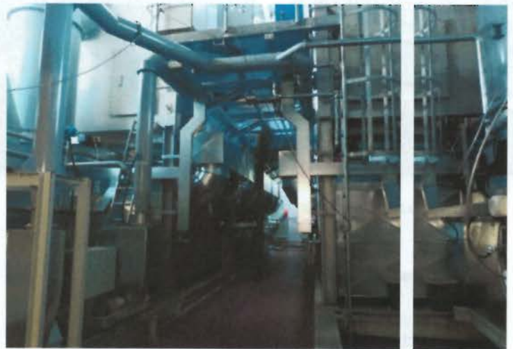
Brennkammer der RTO-Anlage
